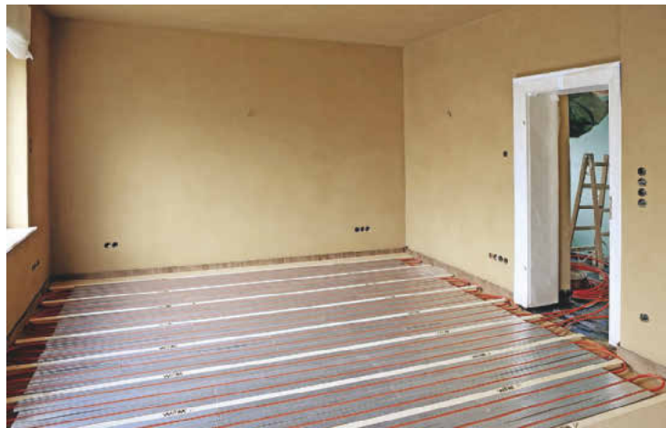
Das Wohnzimmer zeigt die verlegte WEM Bodenheizung und den Lehmputz an Wand und Decke noch ungestrichen.
