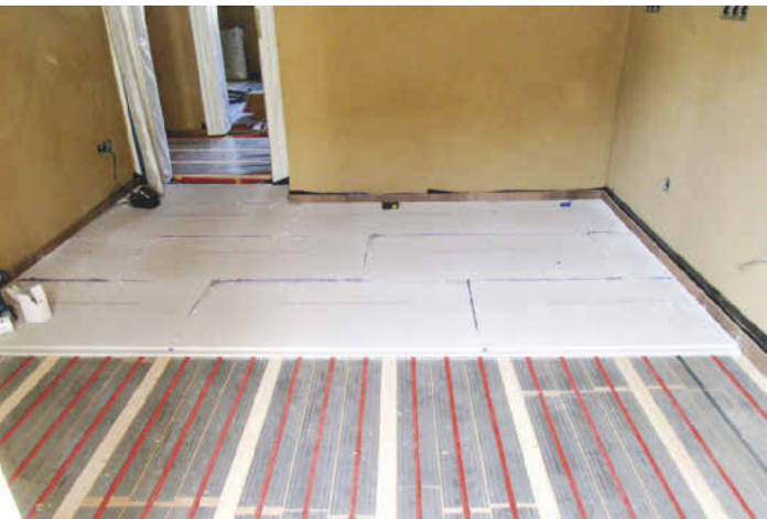
Trockenestrich auf den Bodenheizungselementen in der Küche der Stadtvilla, als Untergrund für Fliesen.
