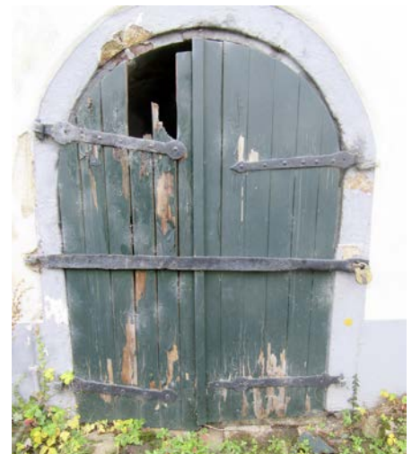
(3) Einseitig stark beeinträchtigte Rundbogentür zum Gewölbekeller durch oberflächlich unkontrolliert abfließendes Regenwasser.
