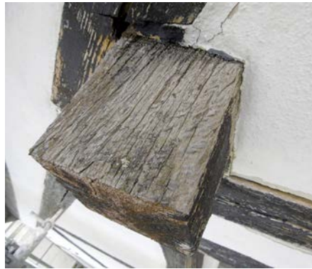
(8) Vor der Sanierung: Ungeschützt auskragender Balkenkopf
