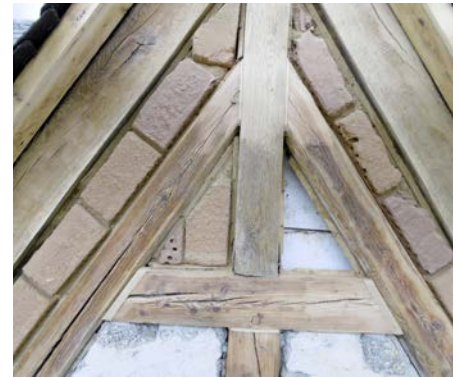
(10) Gereinigtes, in Teilen bereits instandgesetztes Fachwerk mit teilweise neuer Ausfachung mit Lehmsteinen
