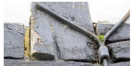
(11) Vor der Sanierung: Verbliebener historischer Zuganker mit sichtbarem, aufliegendem biologischen Bewuchs. Die Y-förmige Ausbildung des Ankers leitete oberflächlich abfließendes Wasser in die Holzkonstruktion.
